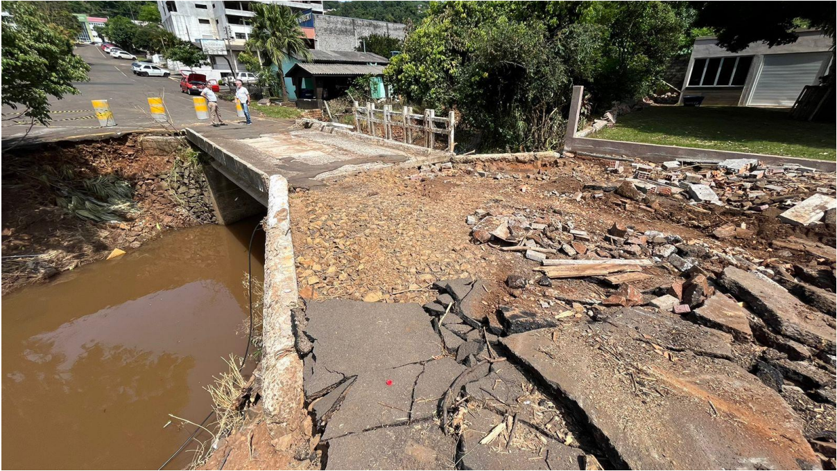
Vista danos na Pavimentação Lado Leste
