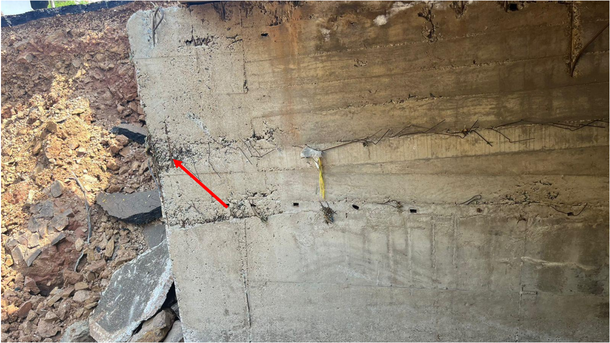
Vista Cabeceira Lado sul (armadura exposta) Necessidade de tratamento
