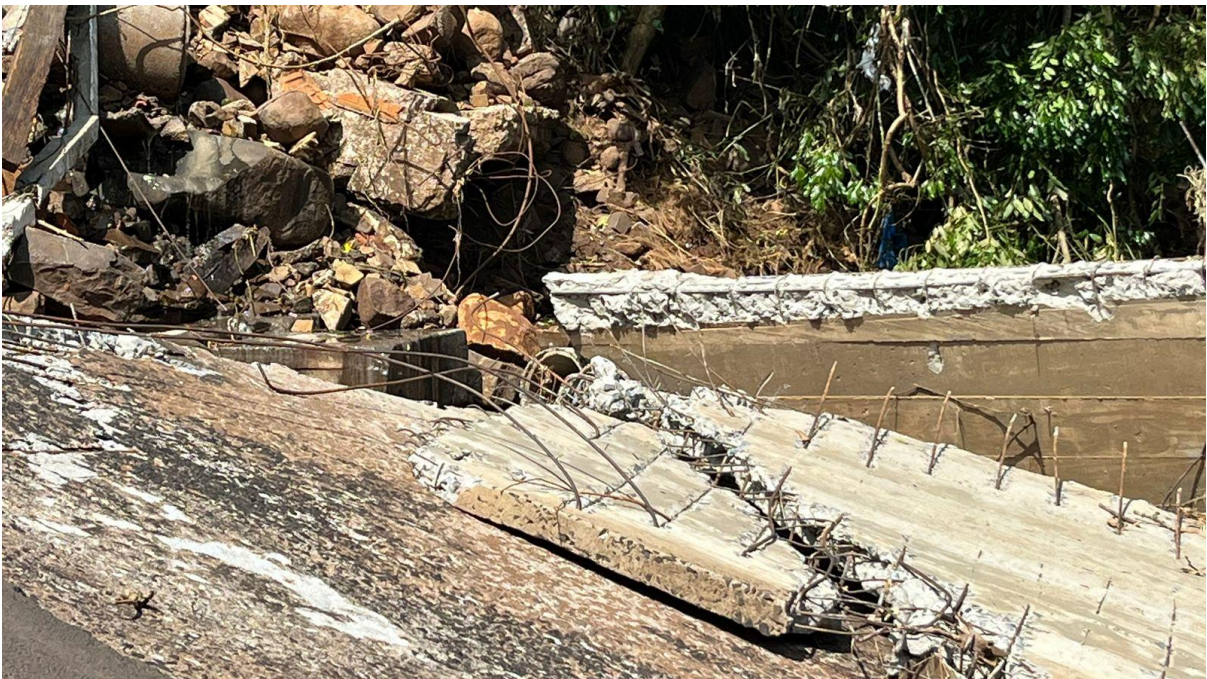
Vista Tablado Ponte em Ruína - (Sentido norte - sul)
