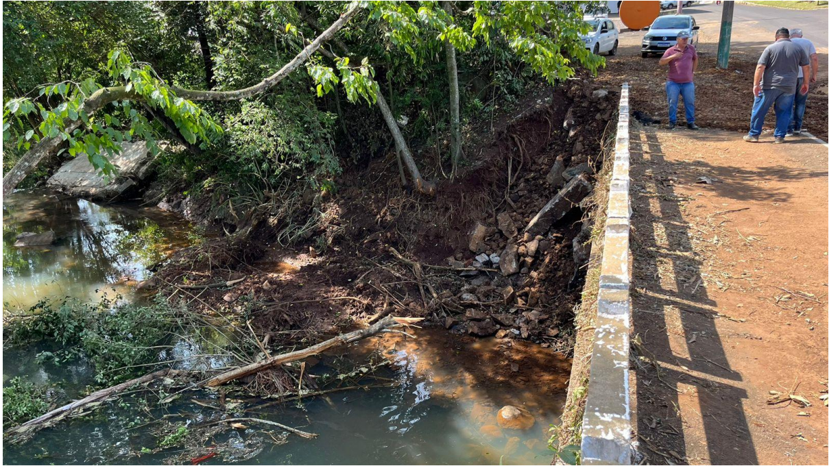
Vista aterro a Jusante (realizar contenção)
