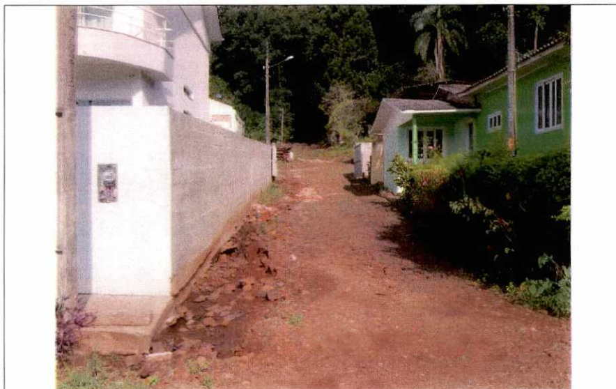
Imagem 5 – Final da tubulação a ser instalada para escoamento das águas pluviais coletadas no local onde será construído o reservatório de retenção de água pluvial na fonte. Coordenadas Lat: 26°43'46.86"S e Lon: 52°43'17.00"O
